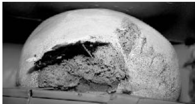
▲金武町役場地下機械室の空調機器ダクト曲部
