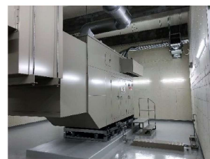
■イメージ写真：非常用発電機設備
