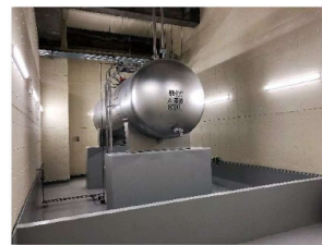
燃料タンク（屋内タンク貯蔵所）
