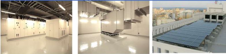
受変電設備・発電機設備・太陽光発電設備イメージ写真
