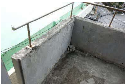
▲コンクリートが剥離した屋外手すり【本庁舎】
