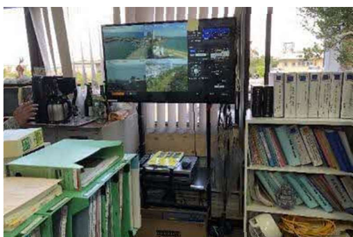
▲防災カメラの映像受信器【本庁舎】
