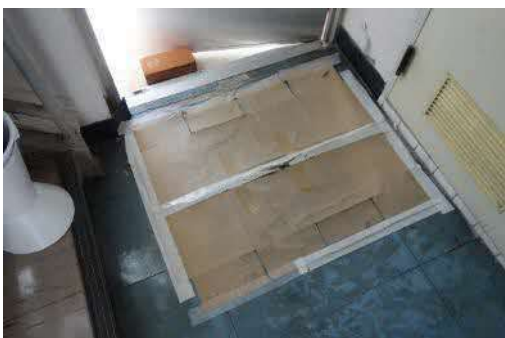
▲応急措置がなされた床面の剥がれ【保健福祉課】
