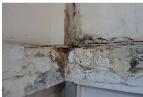
▲屋内のコンクリートの劣化【保健福祉課】
