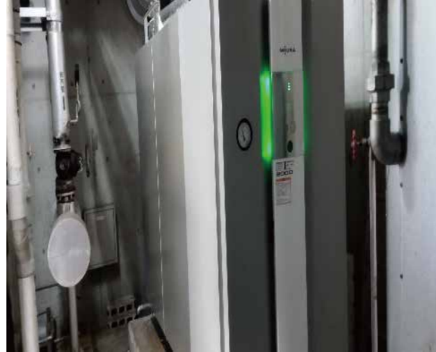
蒸気ボイラー
