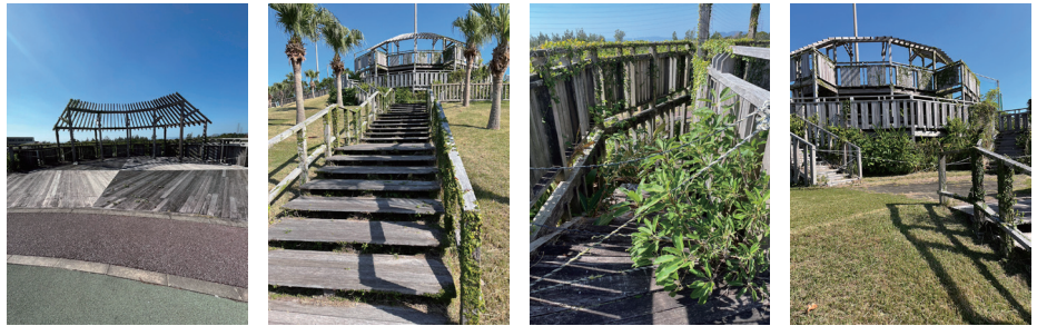
修繕が必要な金武地区公園内の野球場周辺休憩所
