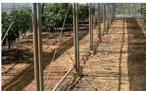
変色した支柱
