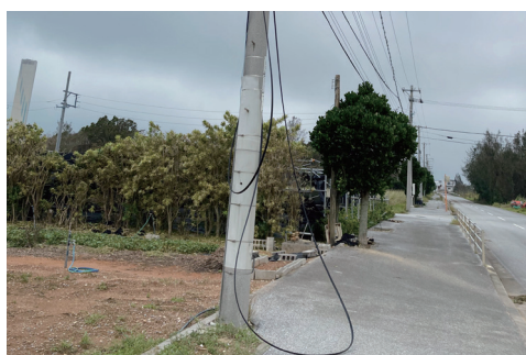
垂れ下がっている電線
