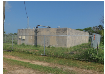
処理能力の改善が必要な配水タンク
