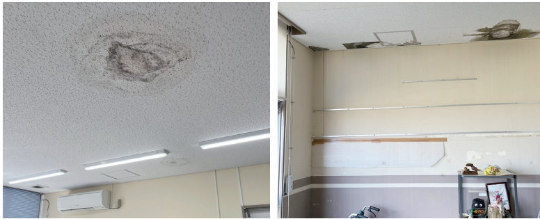
伊芸区事務所の区長室正面壁(左)と調理室天井(右)の雨漏れ
