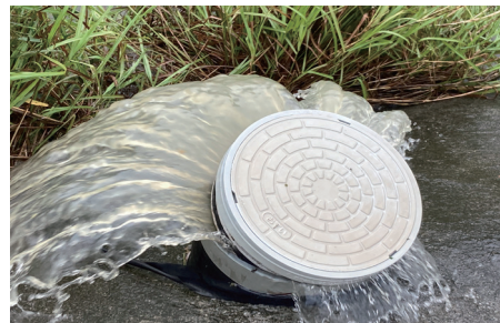
雨水流入の影響で汚水が溢れ出ている塩ビマンホール
