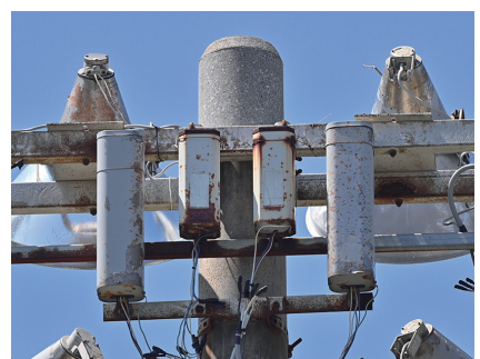
劣化している安定器
