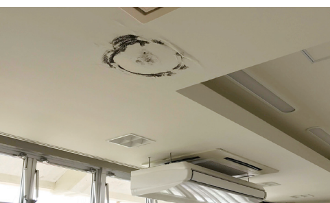
雨漏り等で維持管理費が増えている保健福祉センター
