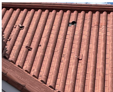
瓦が飛散している屋根
