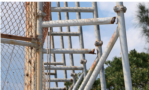
危険な状態のバックネット
