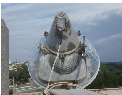
腐食している照明
