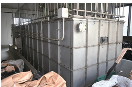
国・県へ補助金8,321万9,131円が返還となった汚泥量調整機構
