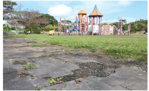
タイルが剥がれている遊歩道
