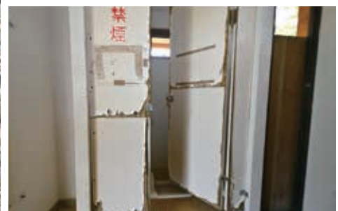
修繕が必要なトイレ
