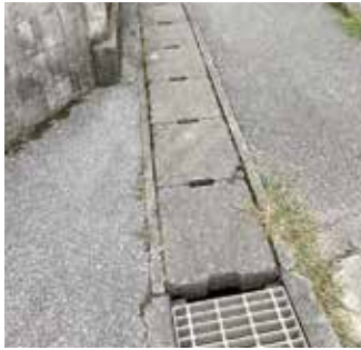
改修が必要な側溝
