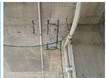
コンクリートが剥がれている天井
