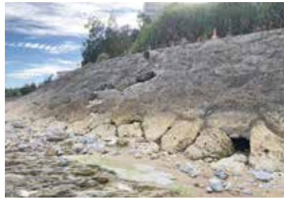
石積みが崩れている塩先原護岸
