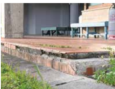
修繕が必要な火葬場
