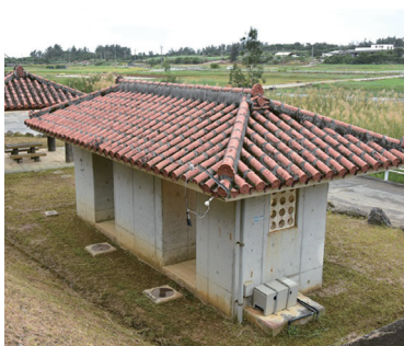
土地改良区内のトイレ (並里区)
