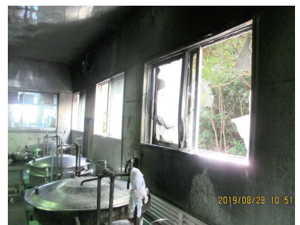
鎮火後の給食センター内部
