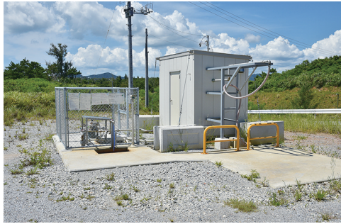
金武町ギンバル温泉揚湯設備
