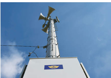
防災無線の屋外スピーカー
