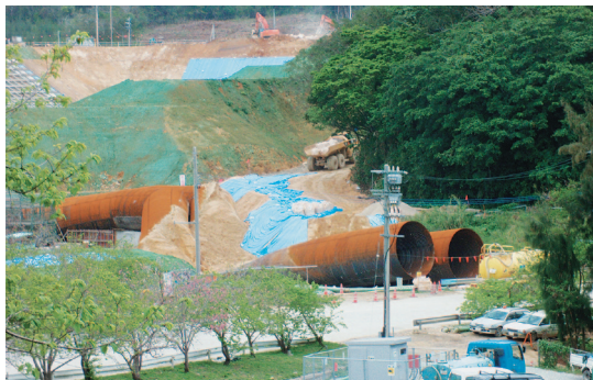
▶大雨の影響でつづれたとみられる大型パイプ
