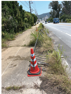
破損している防護柵
