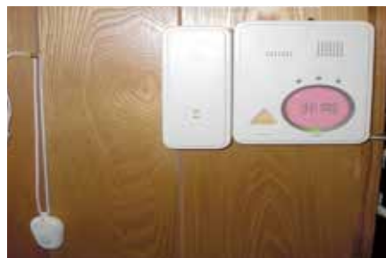
ボタンを押すとオペレーターが対応する緊急通報システム
