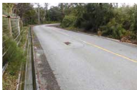
側溝の蓋がない屋嘉42号線
