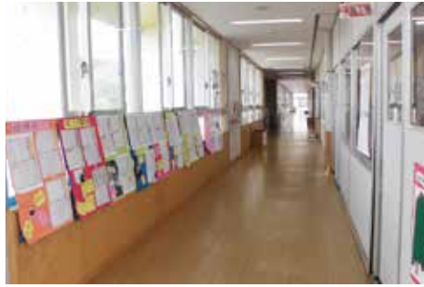
幅員が狭い為手洗い場が設置できない廊下
